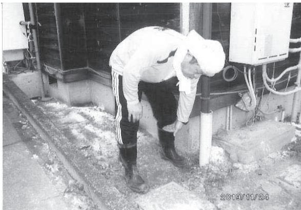
【台風後、床下浸水の状況】
